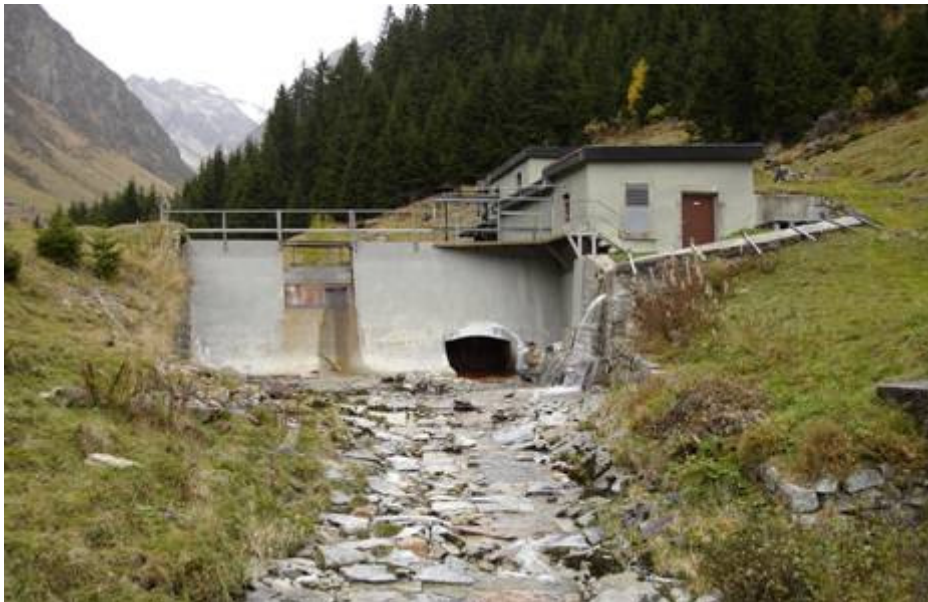
Abb. 3.2 Wasserfassung Gornerbach: Beispiel einer sanierungspflichtigen Anlage. Die wirtschaftlichen Auswirkungen der Sanierung sind bekannt. Die Sanierung erfolgt gemäss rechtsgültiger Verfügung spätestens ab 2010.
