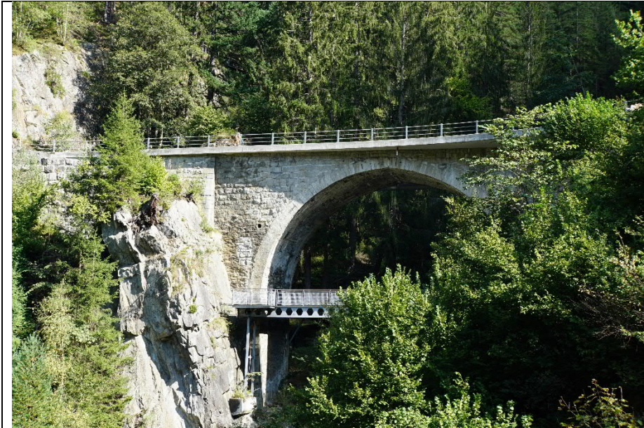
Steinbogenbrücke über den Fellibach, Ansicht unterwasserseitig. Die historische Steinbogenbrücke wurde mit einem modernen Betonüberbau verbreitert. Das beidseitige Eisenröhrengeländer wurde beibehalten. Eine schlichte, aber hier vertretbare Ausführung. Etwas ungünstig wirkt die Abweichung von Brücken- und Fahrbahnachse. Amsteg-Göschenen (AG18)
