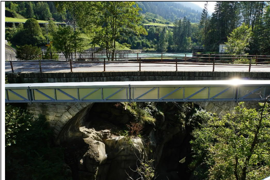
Pfaffensprungbrücke über die Reuss, Ansicht unterwasserseitig. Die neben der Brücke eingebaute Stahlbrücke für die Abwasserleitung stellt ein auffälliges Fremdelement zwischen den historischen Bauwerken Kraftwerk und Brücke dar. Amsteg-Göschenen (AG28)
