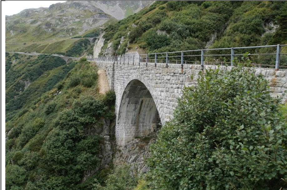
Unterste Bogenbrücke unterhalb des Silberbergs, Ansicht unterwasserseitig. Ungestört erhaltene, originale Brücke der Sustenstrasse. Sustenpass (S28)
