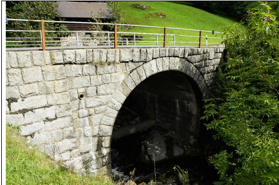
Brücke östlich von Intschi, Ansicht Unterwasserseite. Die Bogenbrücke besteht aus einem Betongewölbe mit Steinverblendung. Gotthardpass (AG7)
