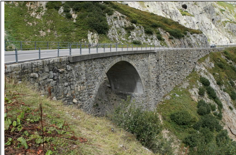
Oberste Bogenbrücke unterhalb des Silberbergs, Ansicht unterwasserseitig. Der über die Mauerfläche auskragende Betonkordon beeinträchtigt das historische Erscheinungsbild stark; sein Schattenwurf wird in der Wirkung noch durch die ungünstige dunkle Oberflächenstruktur nach «Urner Lösung» verstärkt. Sustenpass (S20a)
