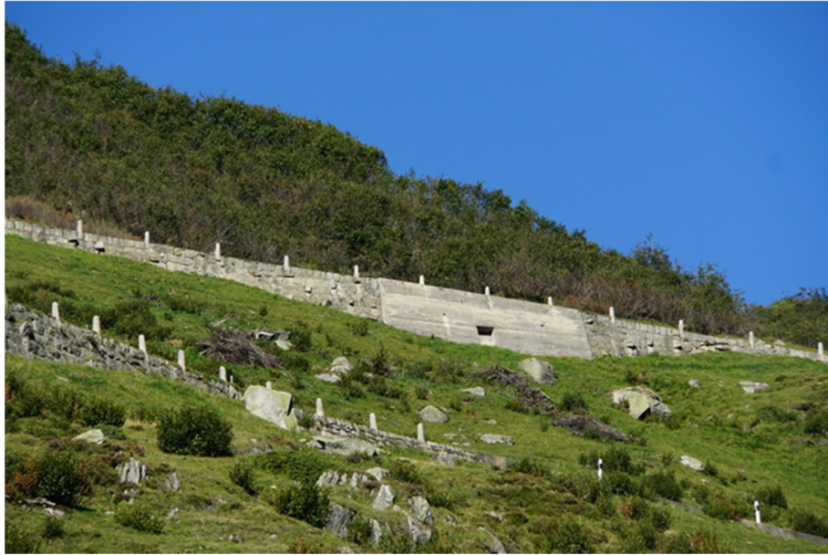
Furkapass : die Sichtbarkeit der Beton-Flickstelle wird noch verstärkt durch den auffälligen Schattenwurf des Durchlasses.
