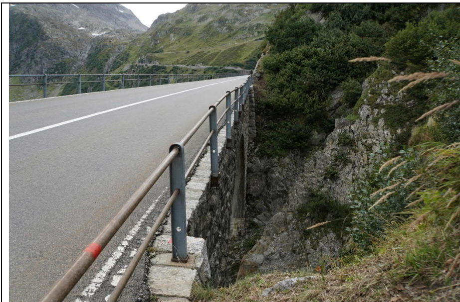
Berg- und talseitiges Geländer auf einer Brücke unterhalb des Silberbergs. Auf der Brücke ist das Geländer seitlich montiert. Das talseitig durchgehende Geländer führt zu einem homogenen Strassenbild. Sustenpass (S28)
