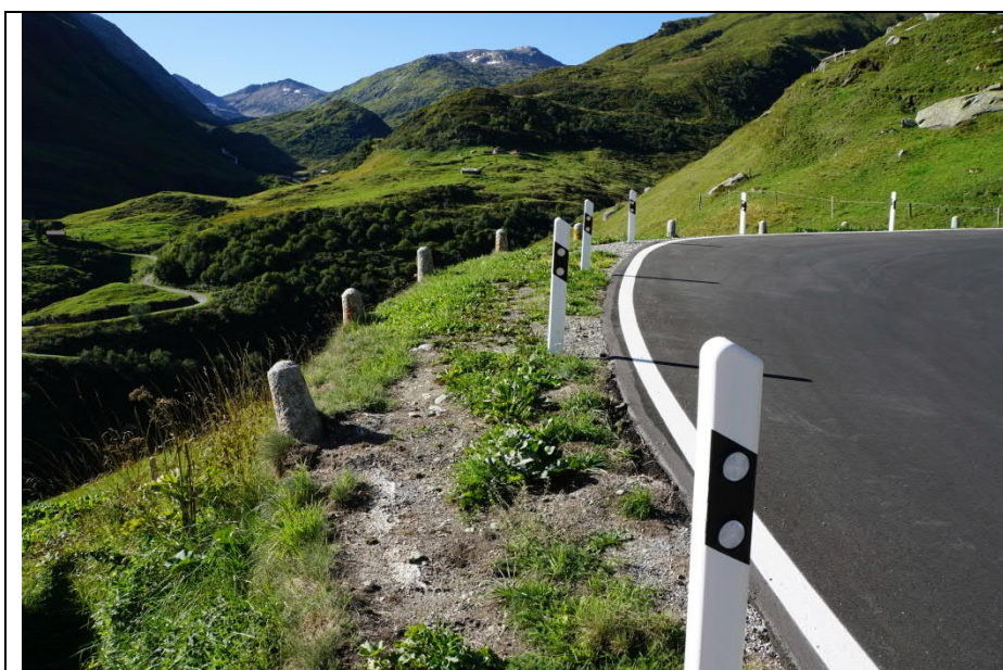
Doppelte Strassenbegren- zung oberhalb von Realp Infolge Korrektur der Kurvengeometrie. Die historischen Kolon- nensteine verblieben in der Mauerkrone der Stützmauer. Der doppelte Strassenabschluss führt zu einem inhomogenen und irritierenden Strassenbild. In solchen Fällen wird empfohlen, die Kolonnen- steine aus der Mauerkro- ne zu entfernen und an den neuen Strassenrand zu versetzen sowie die entstandenen Lücken in der Mauerkrone mit Na- tursteinquadern auszu- mauern. Furkapass (F9)
