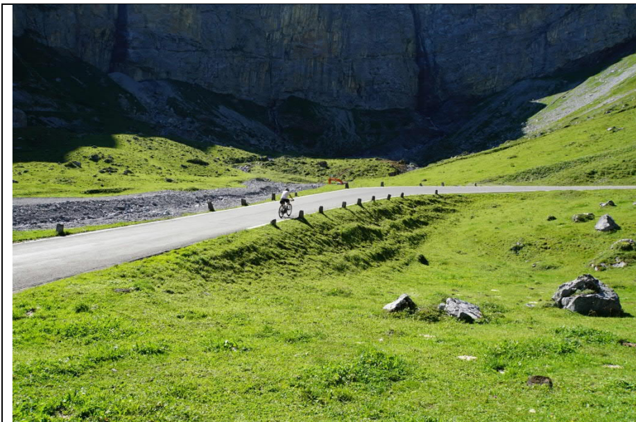
Damm bei Wildbo- den. Die Kolonnensteine zur Strassenabgren- zung sind lückenhaft und sollten ergänzt werden. Klausenpass (K7)
