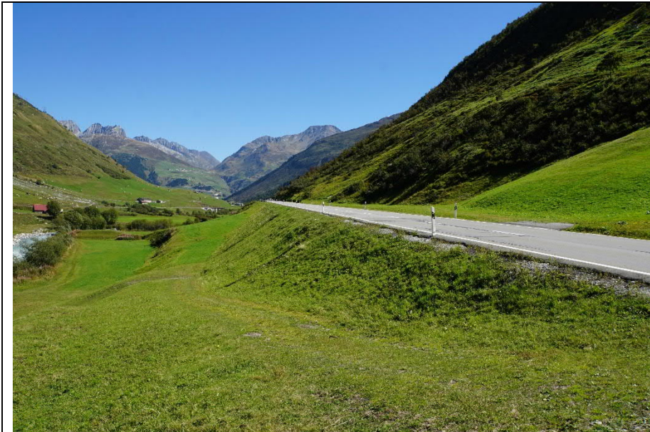
Damm bei Zumdorf Die Fahrbahn wird mit Kunststoff- Leitpfosten begrenzt. Urseren (U16)
