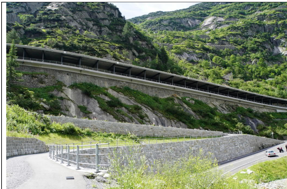
Galerie Bruggwaldboden, Fernwirkung Die Galerie ist mit schlanken Stahlstützen und –träger in Verbundbauweise ausgeführt. Gotthardpass (G13)
