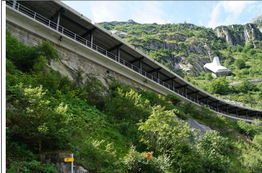
Galerie Bruggwaldboden, seitliche Ansicht Der Kordon weist die gleiche Struktur auf wie bei den angrenzenden Stützmauern. Dies führt zu einem homogenen modernen Erscheinungsbild der Kunstbauten. Gotthardpass (G13)
