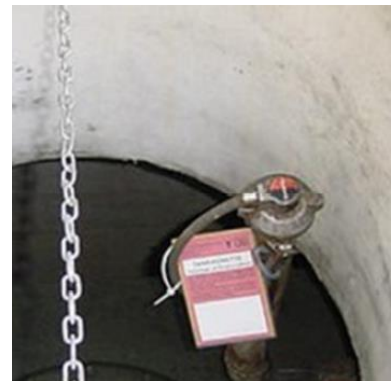
Laminierte Vignette im Domschacht eines erdverlegten Tanks
