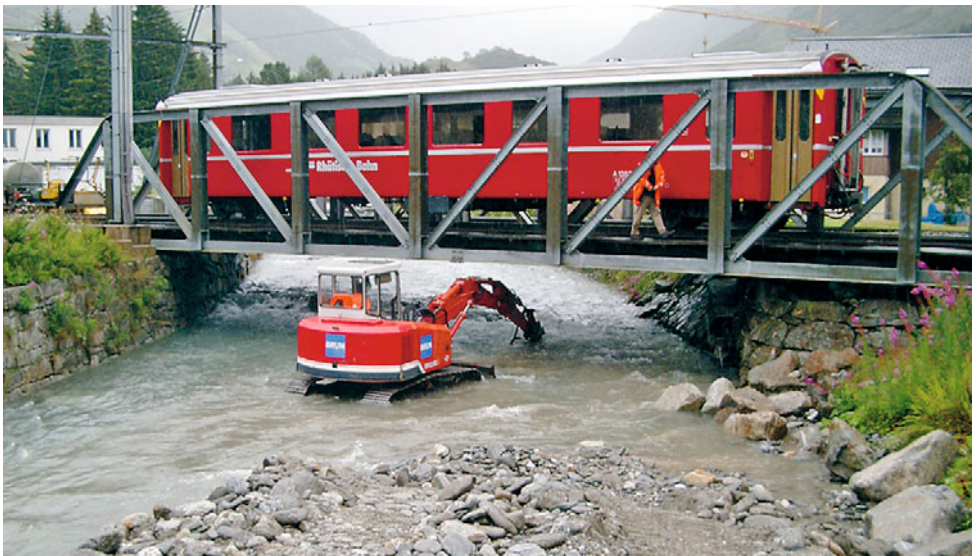
Staugefahr bei Hochwasser: MGB-Brücke über die Unteralpreuss.
