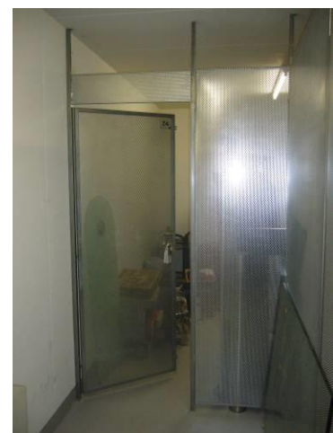
Trennwände aus Lochblech
