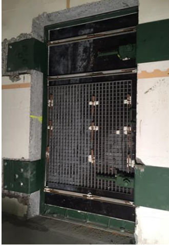
Nachträgliche Panzertüre (PT) mit demontierbare Schwelle
