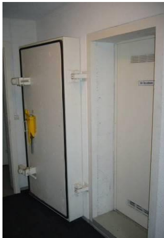
Panzertüre (PT1) mit betonierter Schwelle
