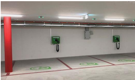
Tiefgarage mit Ladestationen für Elektrofahrzeuge
