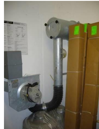
Schutzraumausrüstung beim Ventilationsaggregat
