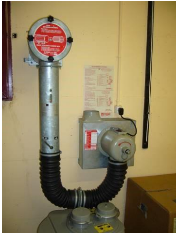
Ventilationsaggregat ohne Verteilleitung
