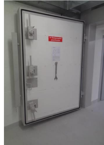
Nachträgliche Panzertüre (PT) mit demontierbarer Schwelle
