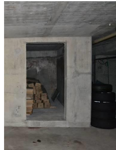
Wasserlager leer mit vergrößerter Öffnung
