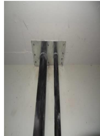
Deckendurchführung einer Abwasserleitung
