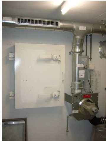
Ventilationsaggregat mit Querverteilleitung
