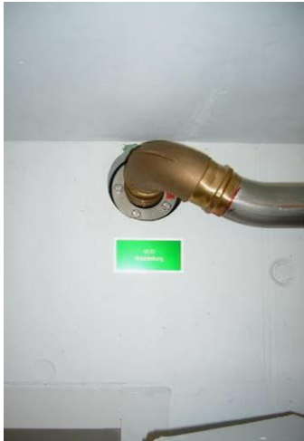
Wanddurchführung einer Wasserleitung
