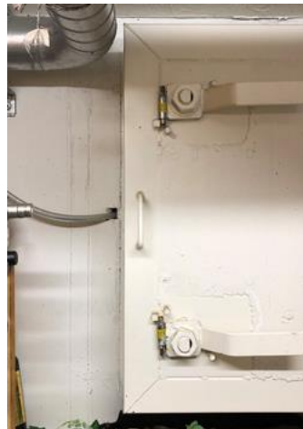
Entwässerung Luftentfeuchter in den Notausstieg/Fluchtröhre
