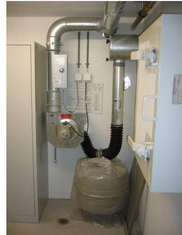
Ventilationsaggregat mit Direktverteilung
