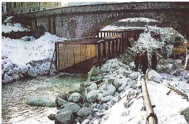
Bild 6. Hauptschutzelement C. Umleitkanal bei der Dorfbrücke.
