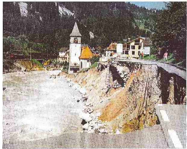
Bild 2. Zerstörte Kantonsstrasse südlich Gurnellen.
