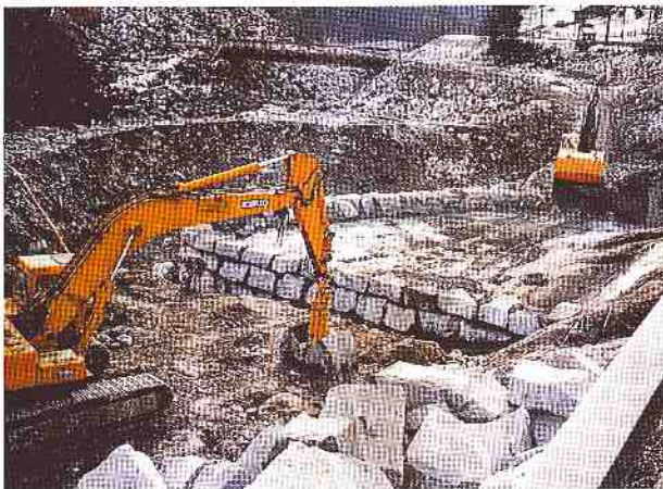
Bild 2. Hauptschutzelement A. Schichtweises Versetzen von Blocksteinen im Fundationsbereich des Umlenksporns. Armierung für einen diagonal halbierten Betonwürfel (Kantenlänge 2,75 m).
