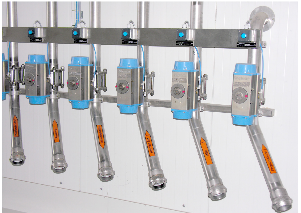
Abb. 6 Abfüllstelle bei einer ortsfesten Tankanlage (Firma Halag, Kt. Thurgau)
